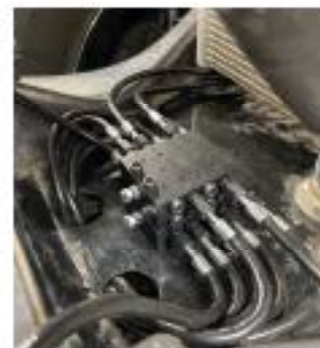
Sistema de lubricación centralizado cargador frontal y elevador deltabara Serie B.
